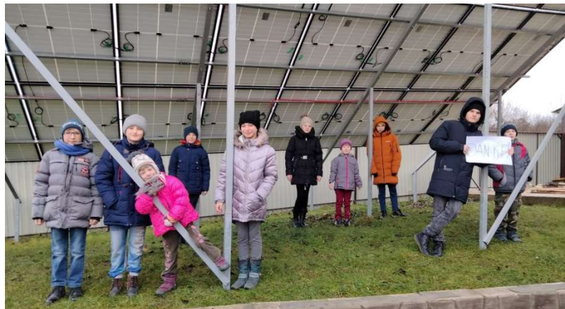
„DANKE“ steht auch auf diesem Zettel der Kinder vor der zweiten Photovoltaikanlage
